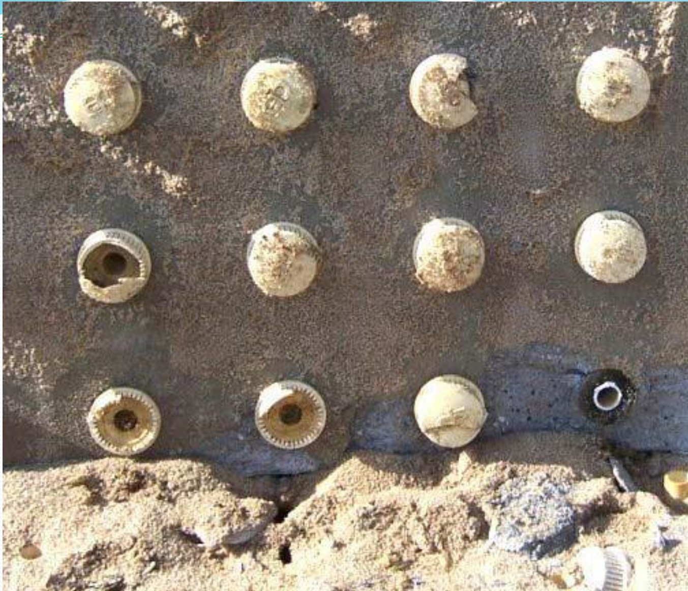
Busettes PVC détériorées
