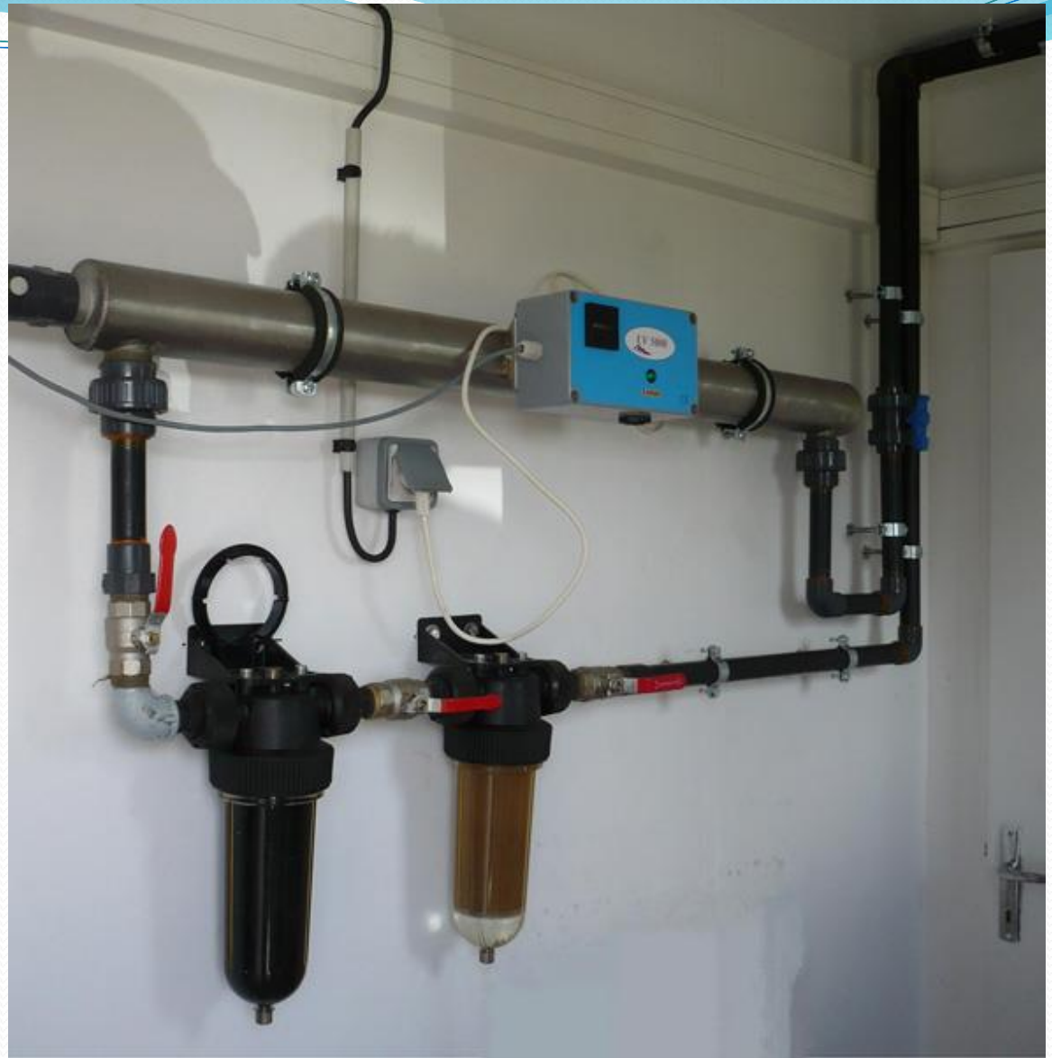
Installation de désinfection par UV
