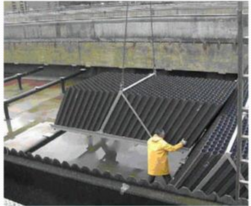
Décanteur à tubes fortement inclinés
