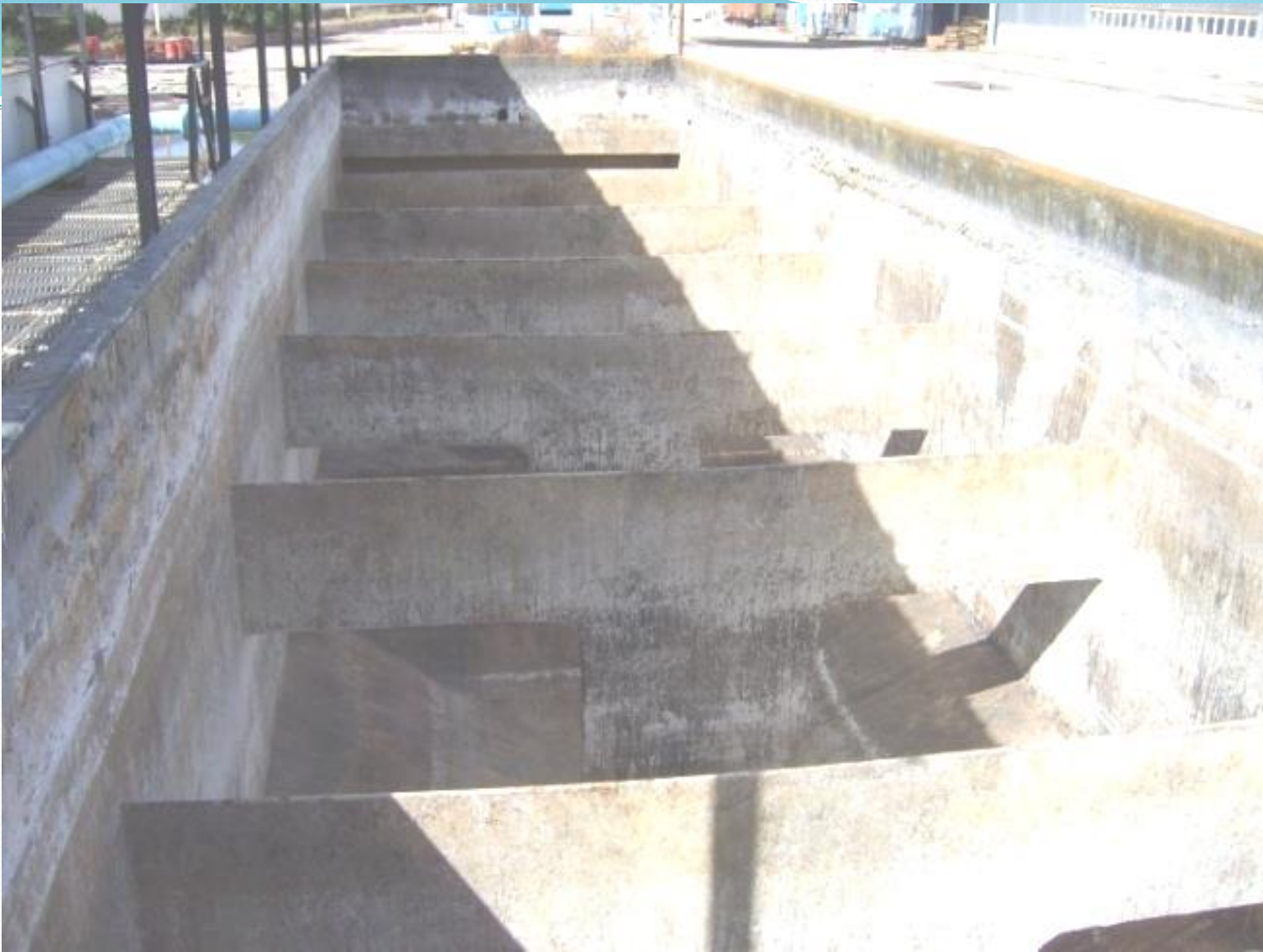
Décanteur statique à plusieurs compartiments
