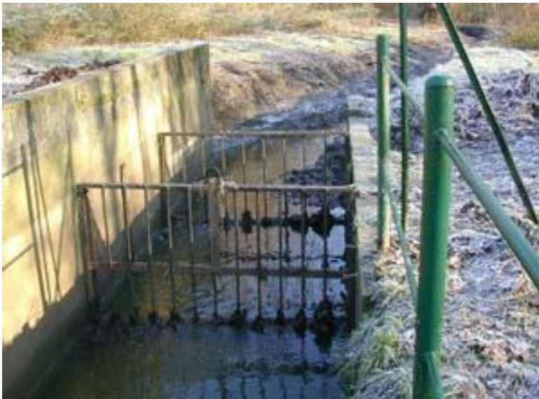
Dégrilleur destiné à retenir les objets flottants avant l'entrée d'un étang
