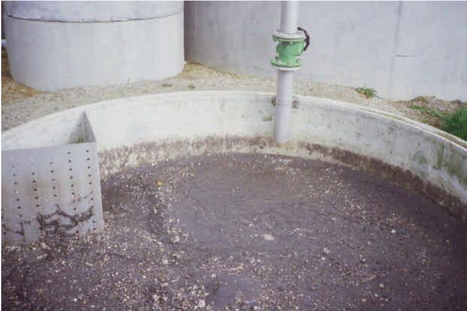
Extraction du sable d'un dessableur
