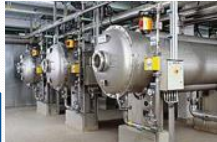
Générateurs d'ozone de l'usine de traitement des eaux Charles-J. Des Bailleurs
