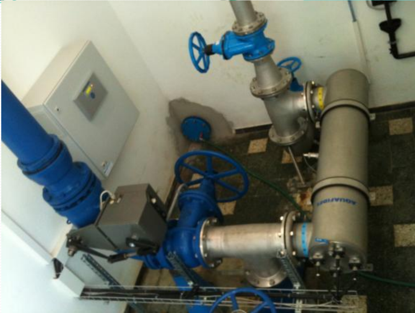
Installation de désinfection par UV
