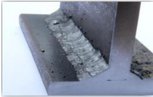
Figure 93 : Fissuration à chaud
